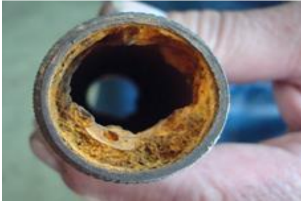
Rohr mit Ablagerungen im Oktober 2007
